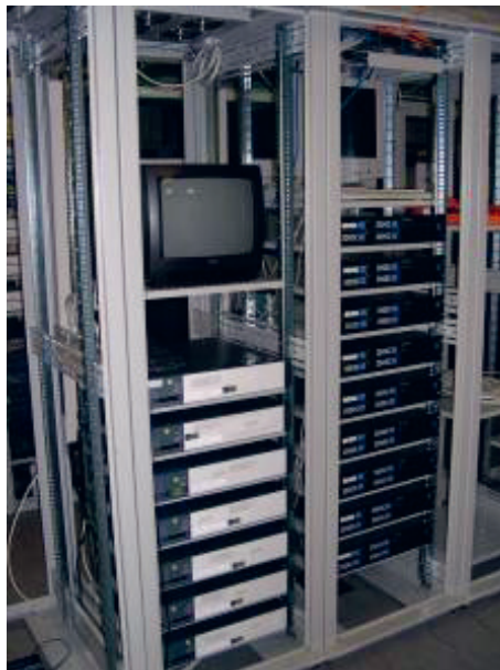
Une baie de serveurs
