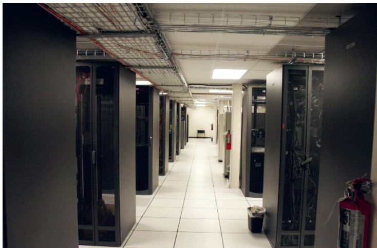
Un data center, dans lequel on voit plusieurs baies de serveurs
