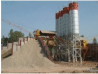
fig. 7.1: Centre de fabrication du béton
