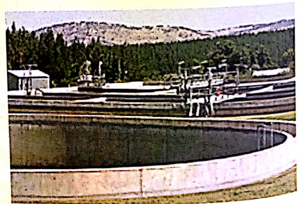
Fig 2 : Un bassin de traitement d'eau.
