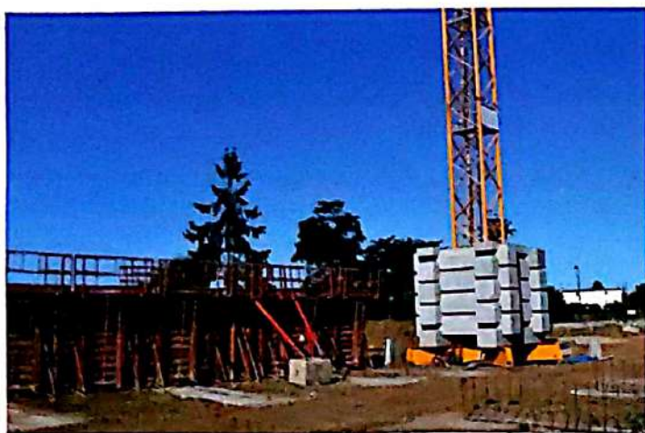
Doc. 5 Contrepoids sur jambes de force au pied d'une grue.
