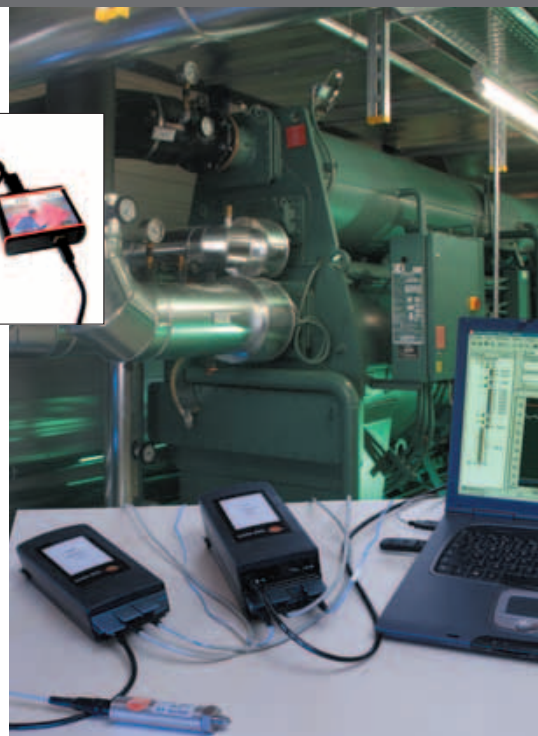
Mesure de la surchauffe, du sous-refroidissement et de la pression du fluide sur une installation frigorifique
