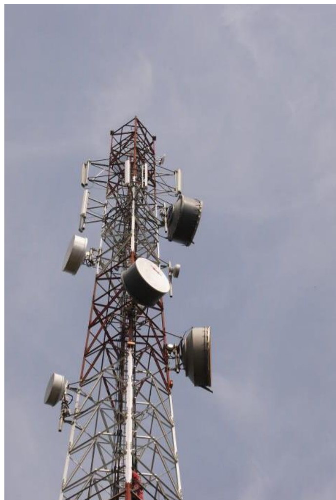
Photo 39: Pilonne de télécommunication
