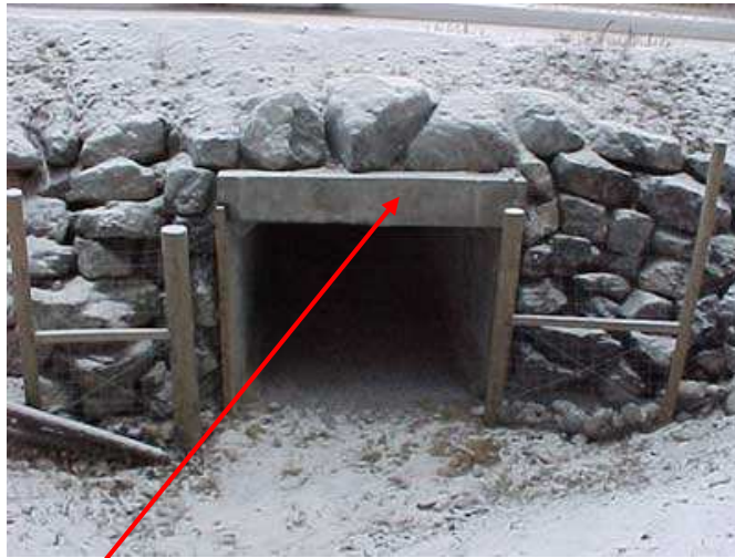
Un dalot pour l'assainissement routier
