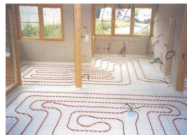
Echangeur de chaleur = plancher chauffant / rafraîchissant
