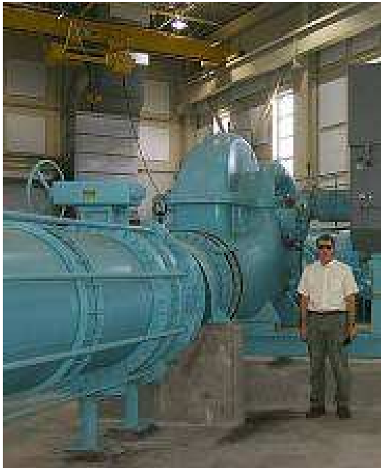
Pompe monoétage (centrale thermique à flamme)
