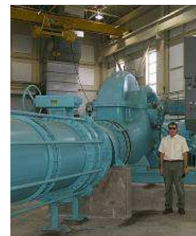
Pompe monoétage (centrale thermique à flamme)
