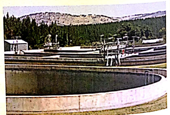
Fig 2 : Un bassin de traitement d'eau.
