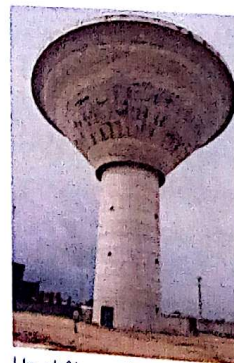
Un château d'eau
