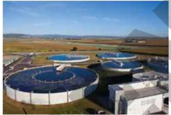
Figure 2 : Station de traitement des eaux usées
