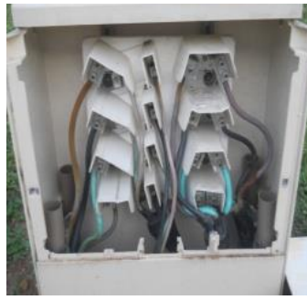
Grille du coffret
